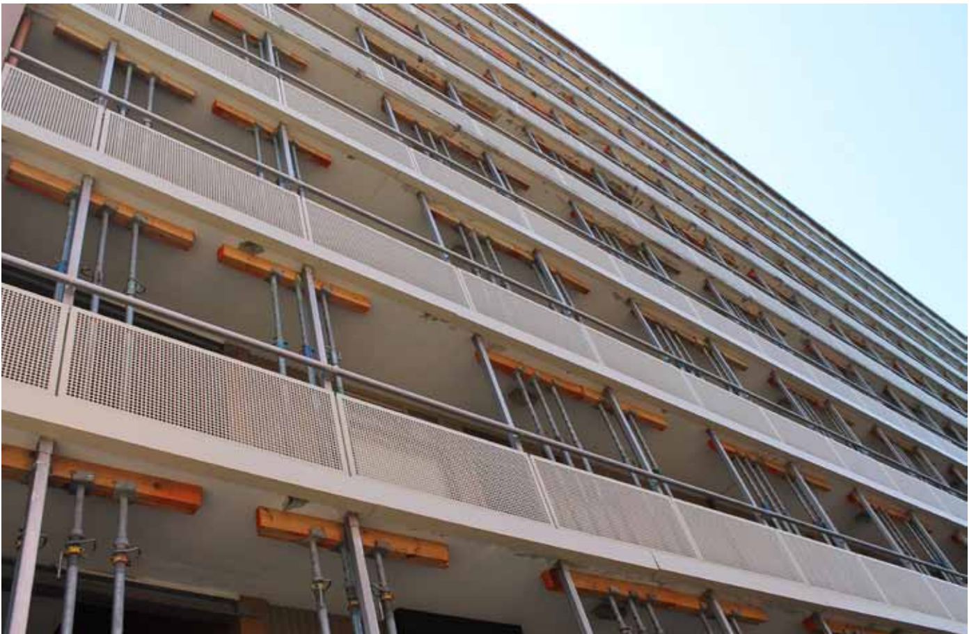
Gravierende baukonstruktive Probleme zwingen die Wohnungsbaugesellschaft Heem Wonen zum Abriss der vier Wohngebäude.
